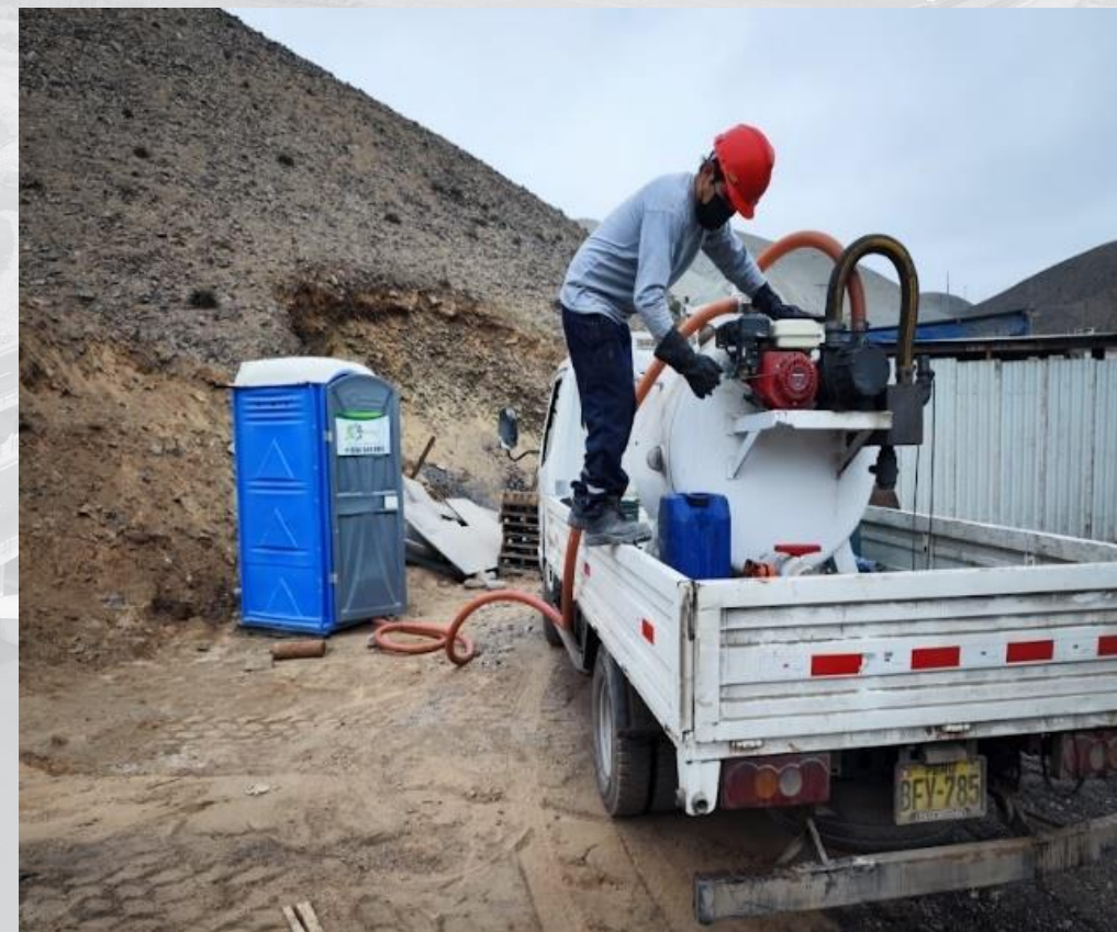
Instalación de baños químicos y respectivo mantenimiento
