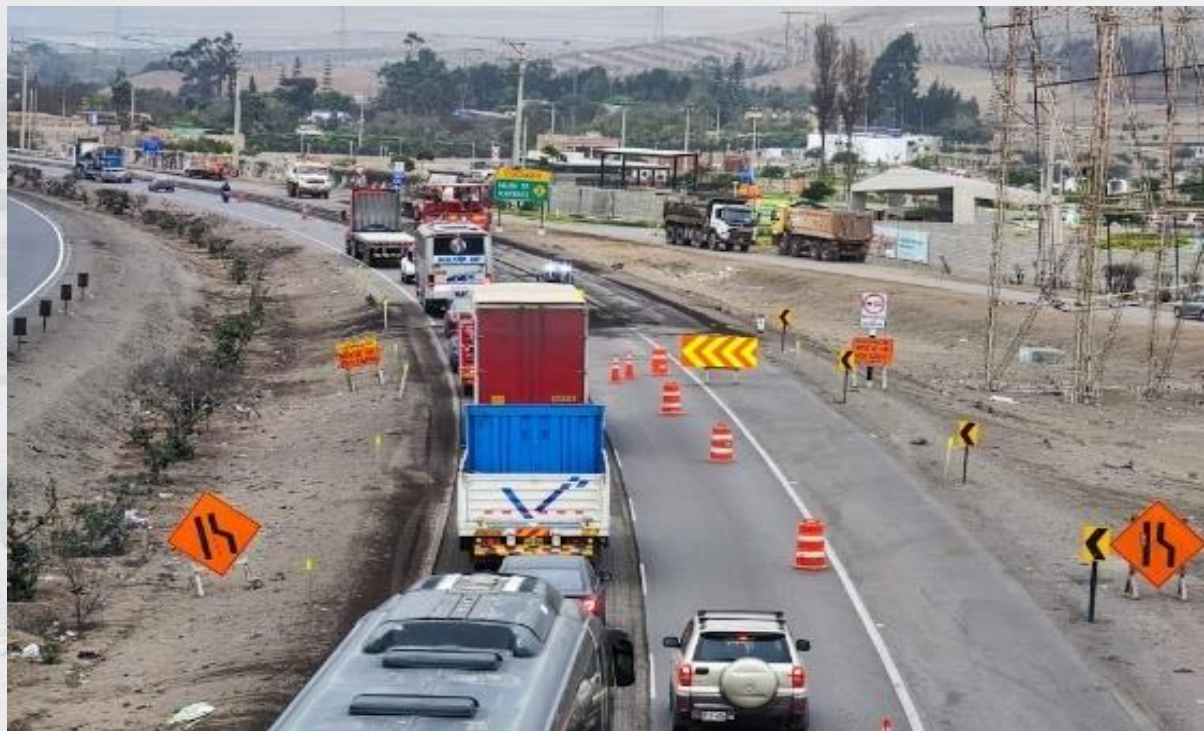
Señalización de seguridad vial
