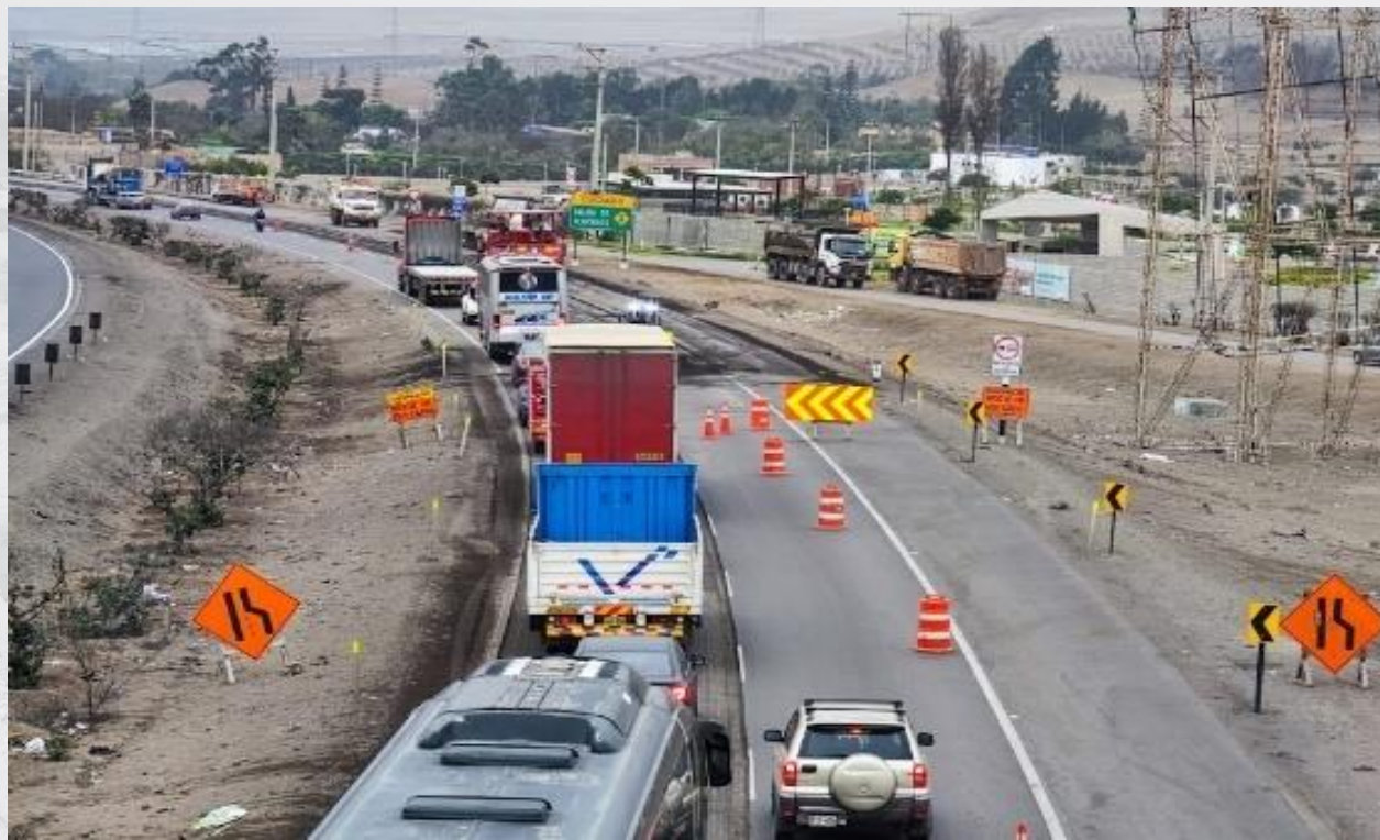
Señalización de seguridad vial
