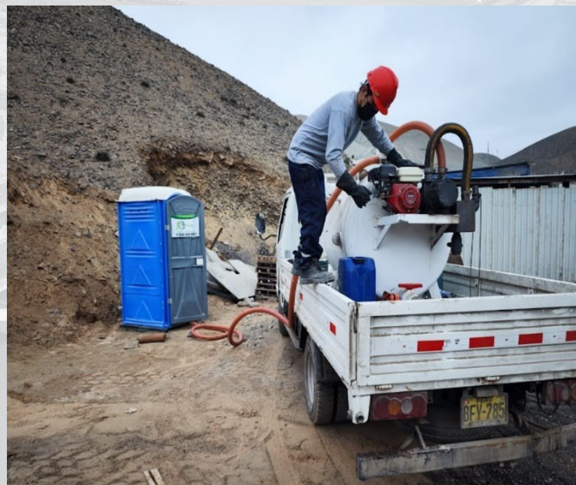
Instalación de baños químicos y respectivo mantenimiento
