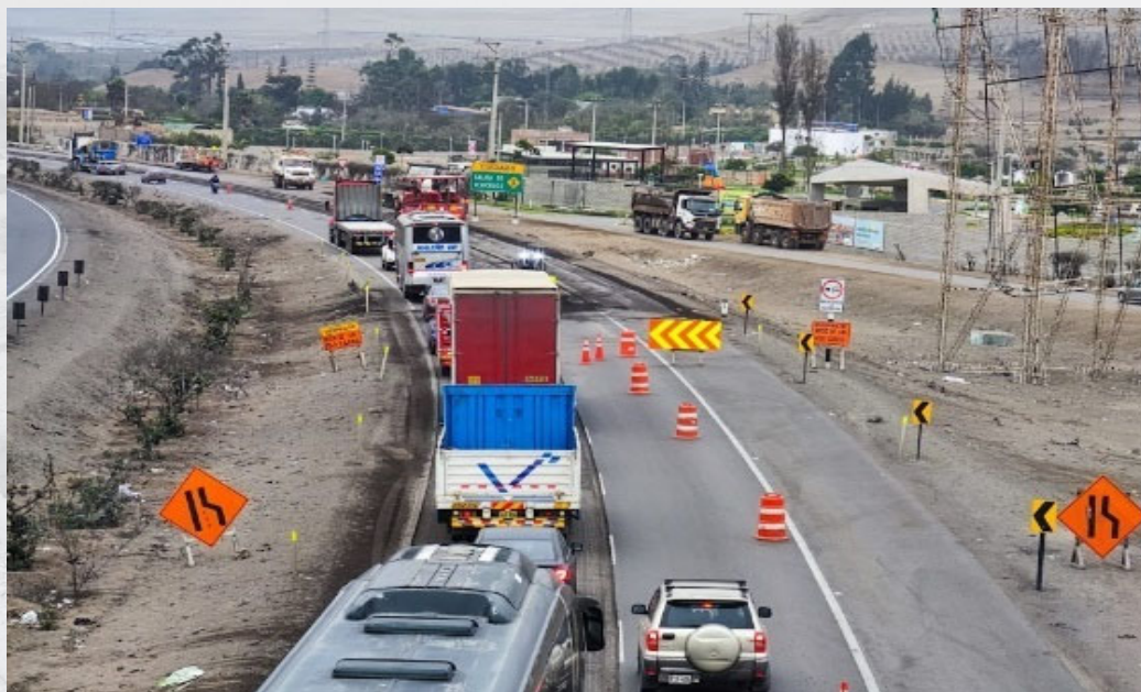
Señalización de seguridad vial
